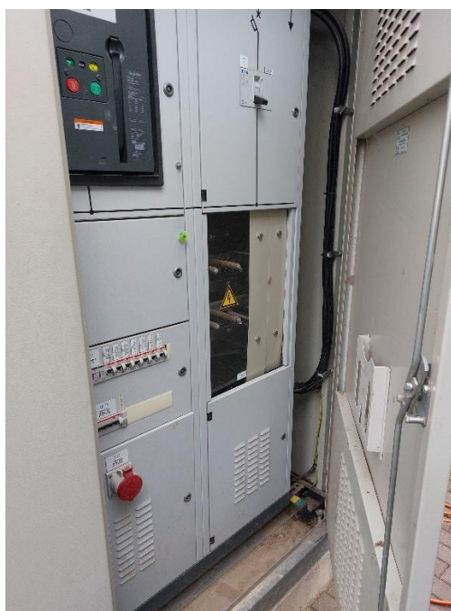
5 pav. Modulinės transformatorinės Nr. Jn-1106 A, 0,4kV dalies vaizdas
