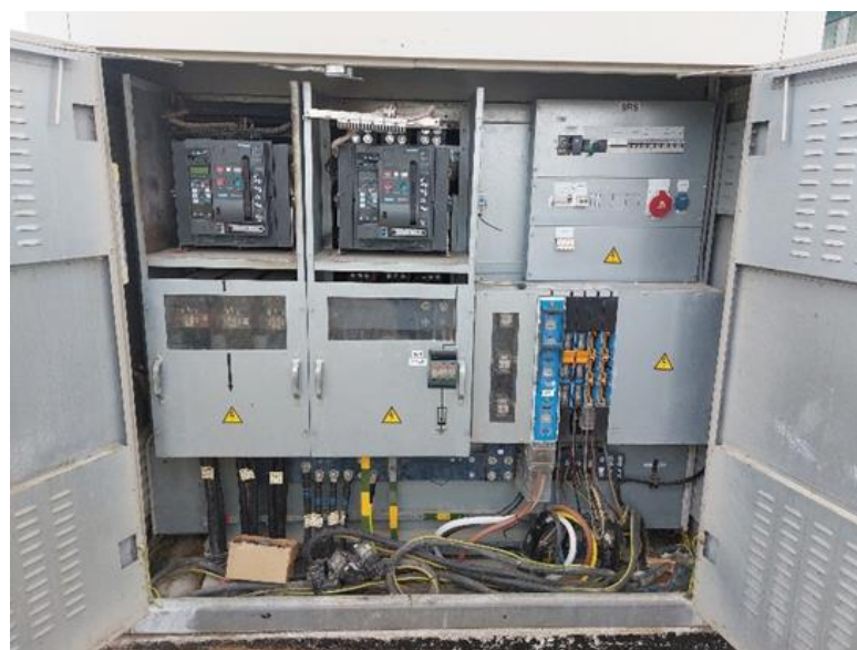
4 pav. Modulinės transformatorinės Nr. SR-424A, 0,4kV dalies vaizdas
