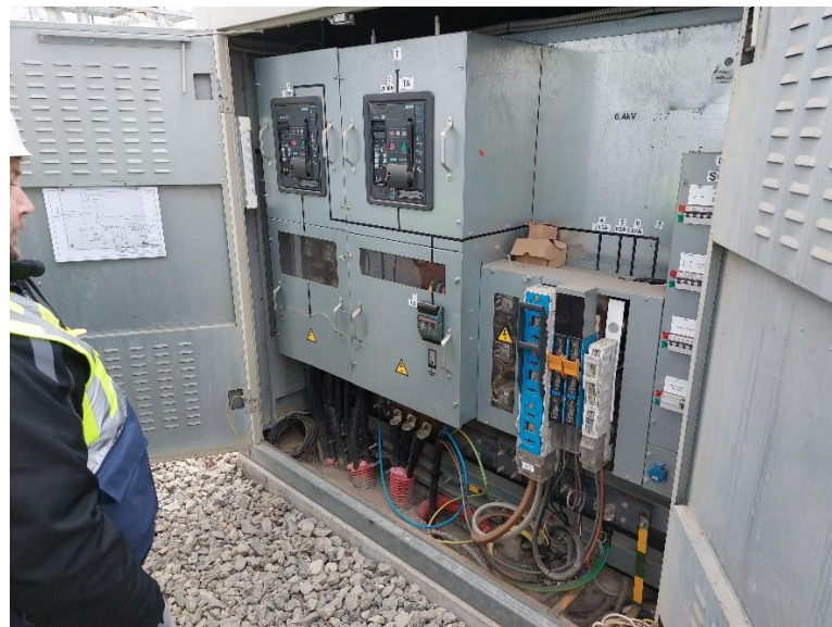
4 pav. Modulinės transformatorinės Nr. M-404, 0,4kV dalies vaizdas
