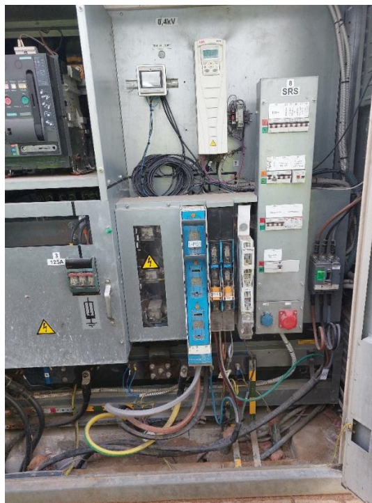
4 pav. Modulinės transformatorinės Nr. Tt-713A, 0,4kV dalies vaizdas
