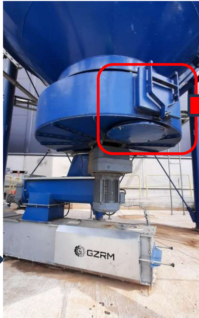
Paveikslas Nr. 5. Po silosu esantis atsarginis flanšas.
